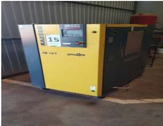
• Compressor de ar comprimido
