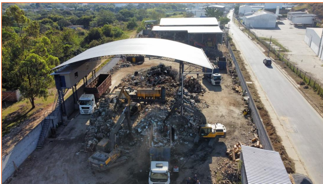
Figura 3 - Estrutura da nova unidade industrial, incluindo sistema de geração de energia solar e cabine elétrica modernizada para atendimento à demanda dos novos maquinários
