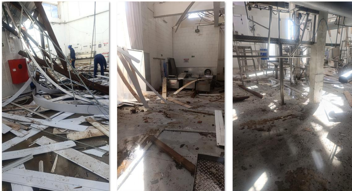
Figura 9 - Imagens fotográficas dos danos estruturais causados pela catástrofe natural de 30.12.2025
